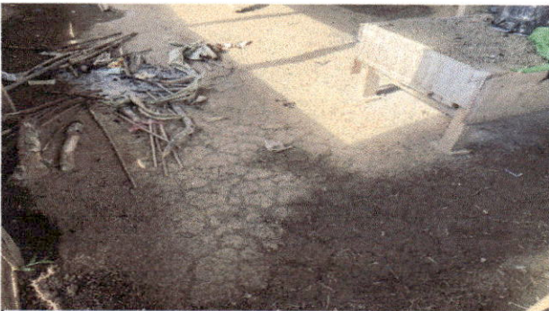
Foto 5: Cocina con piso rajado.
