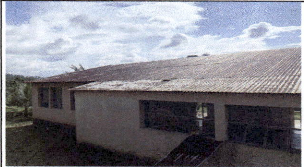
Foto 3: Lámina del módulo 1 dañada.
