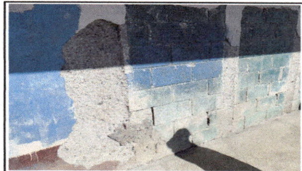
Foto 4: Muro de mampostería dañada.
