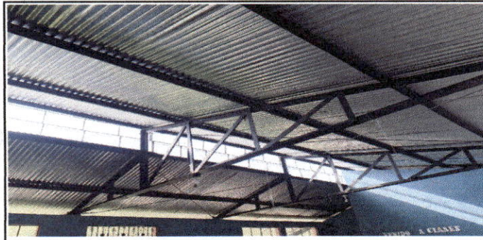
Foto 7: Lámina del módulo 1 con filtración de agua.
