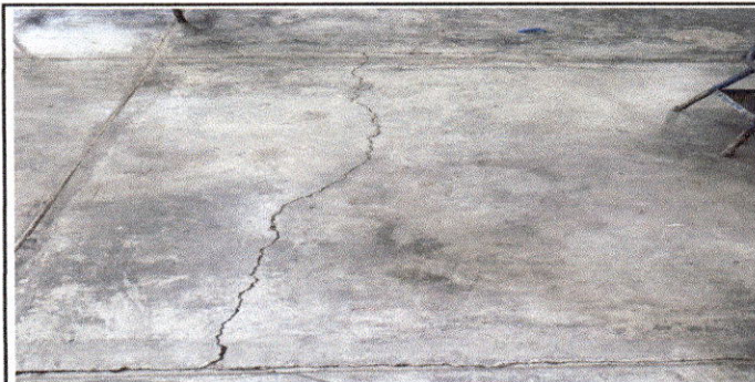
Foto 9: Piso del módulo 1 con quebrada.
